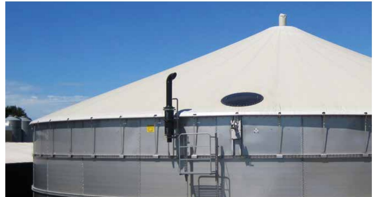
Copertura per biogas su vasca in acciaio
