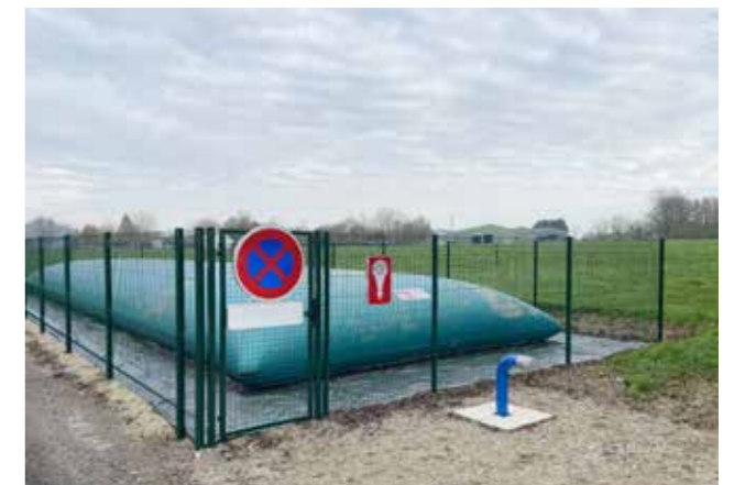
Stoccaggio dell'acqua antincendio
