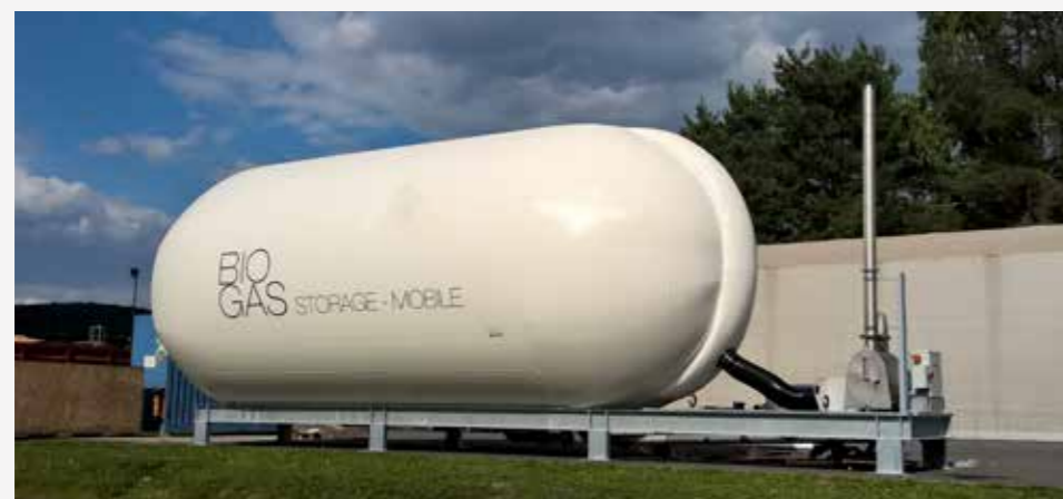
Stoccaggio gas a noleggio 150 m 3
