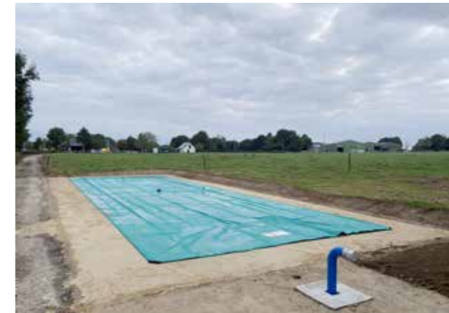
Stoccaggio dell'acqua antincendio
