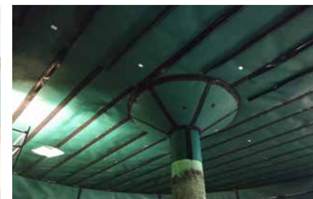
Ristrutturazione della parete con funghi del soffitto
