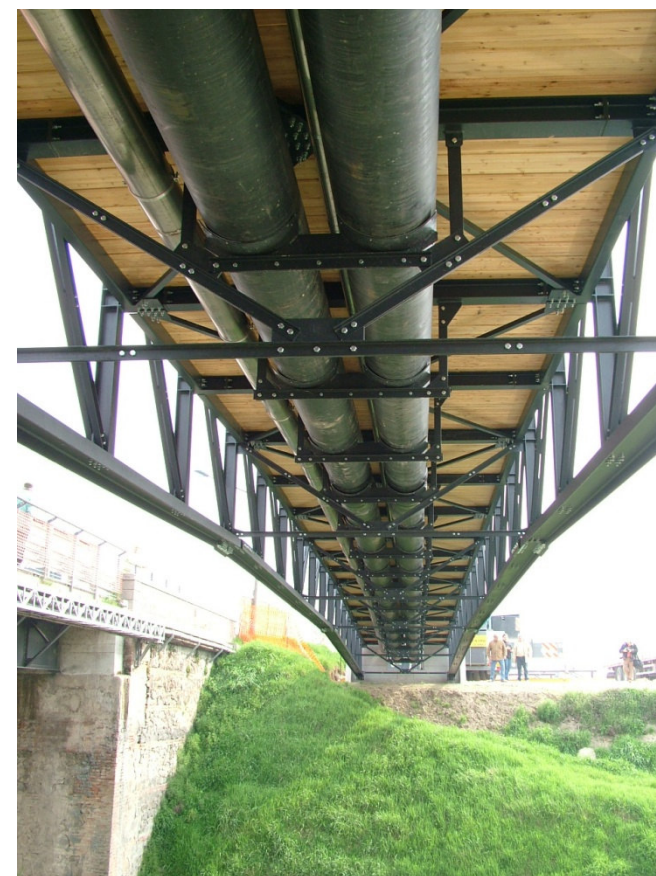
Particolare tubazioni della rete di teleriscaldamento
